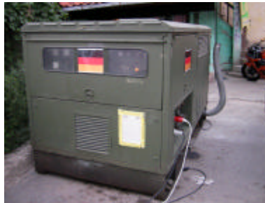
Einer der unzähligen Generatoren
